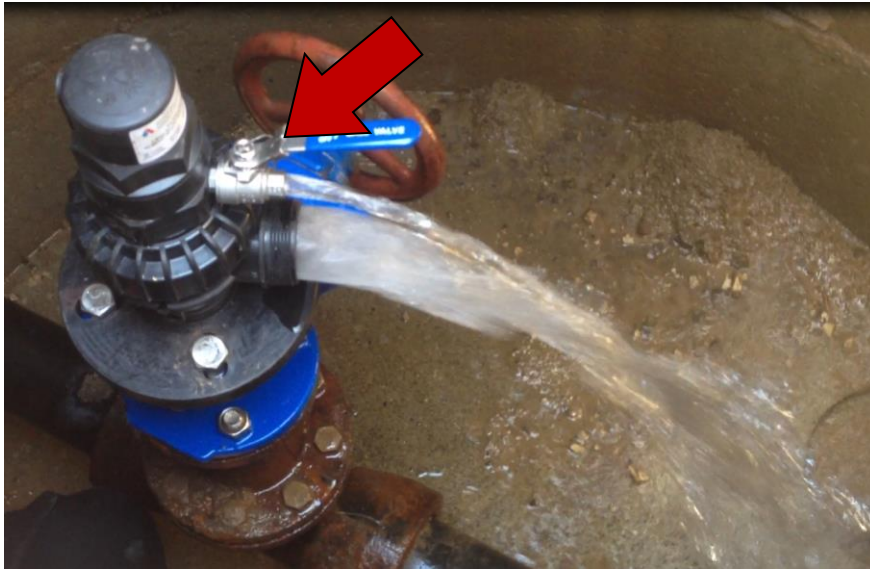
Foto: Austretendes Spülwasser bei geöffnetem Spül-/Entspannungshahn (roter Pfeil)
